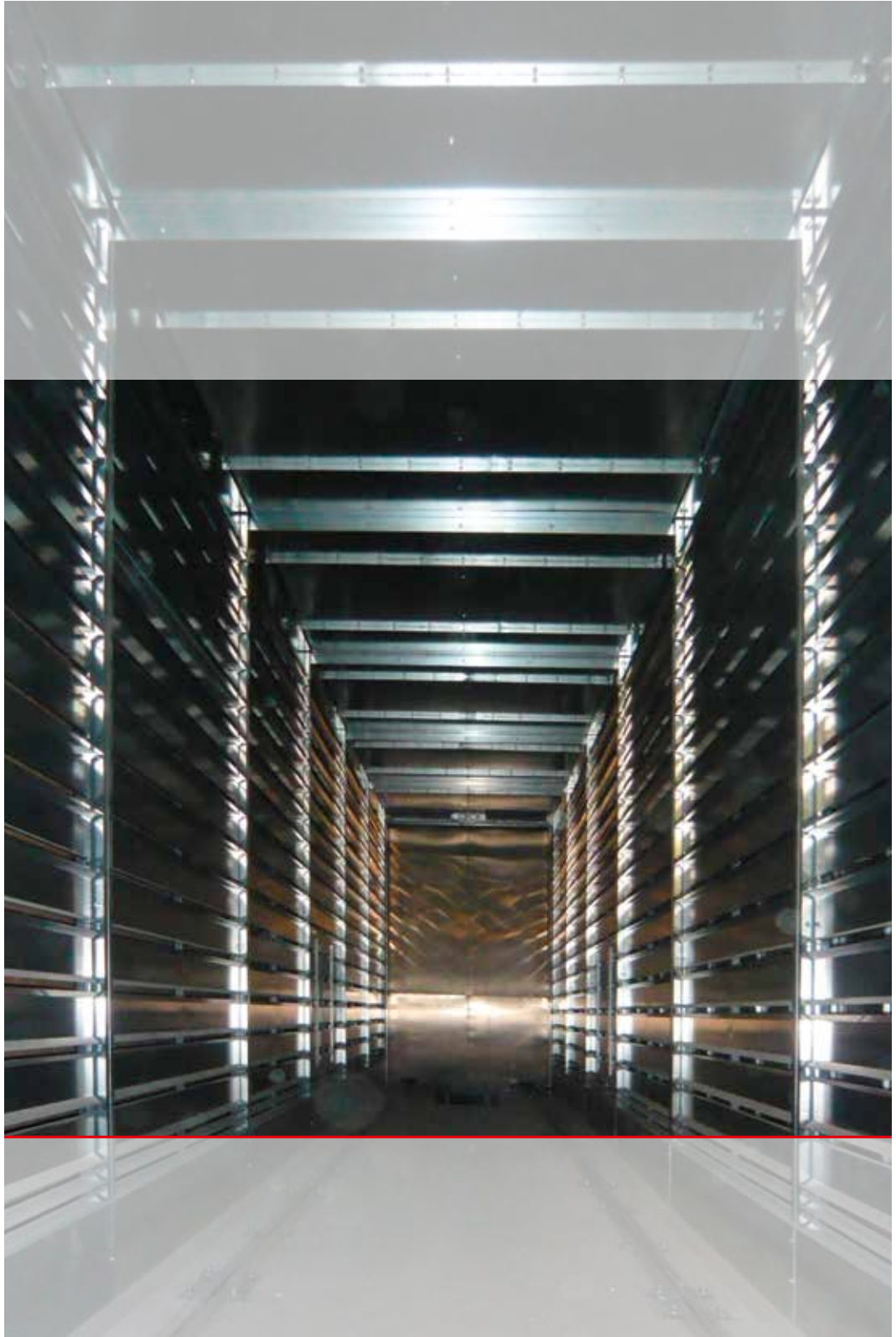
Schlitzdüsenwände im Trocknergang
