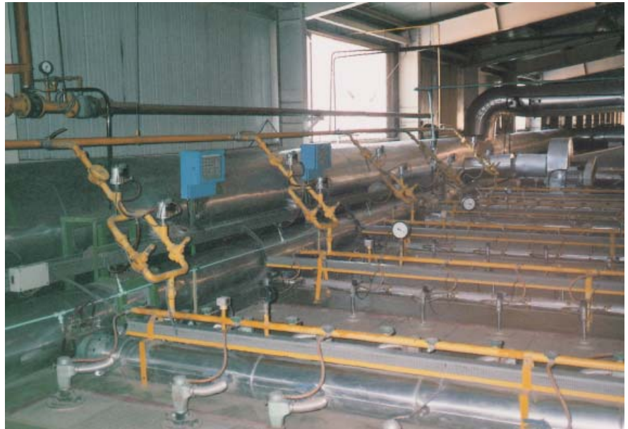
Система газовых горелок на тоннельной печи
