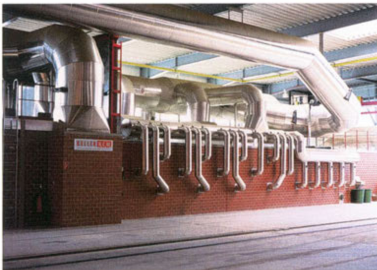
Vorwärmer und Ofeneinfahrt Pre-heater and kiln entrance
