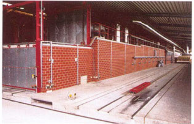
Ofenausfahrt mit Schleuse beim Keller-Tunnelofen im Hallenanbau des Zubehörwerkes Kiln exit with sluice of Keller tunnel kiln in the extension of the accessories works building
