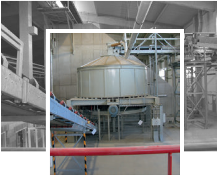
Kollergang im Bereich der Materialaufbereitung
