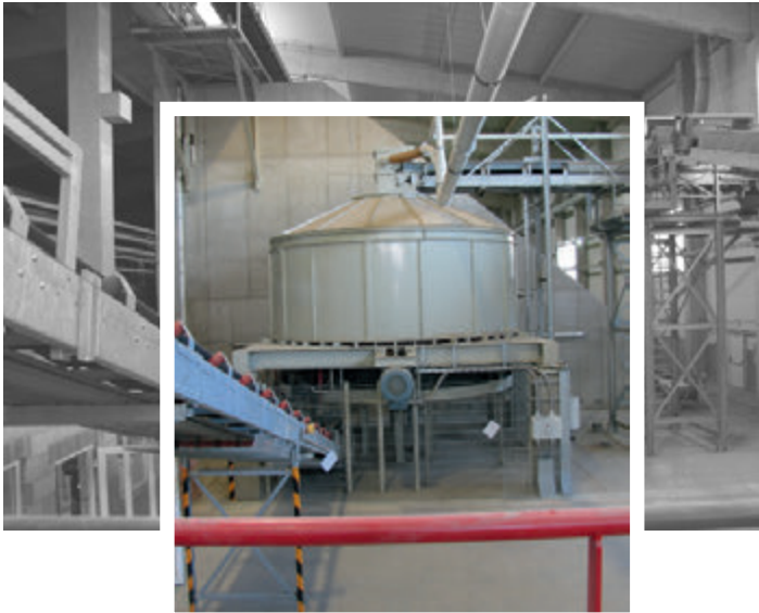
Kollergang im Bereich der Materialaufbereitung
