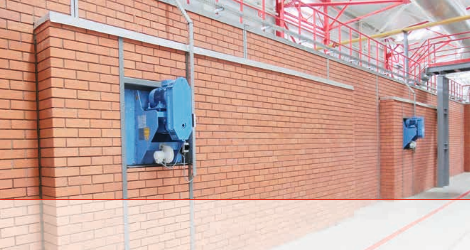
Rauchgasumwälzung in der Aufheizzone des Tunnelofens Система циркуляции дымовых газов в зоне подогрева туннельной печи
