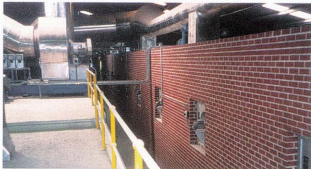
Die Umwälzventilatorantriebe des Tunneltrockners befinden sich auf idealer Wartungshöhe The recirculating fan drives of the tunnel dryer are at an ideal height for maintenance
