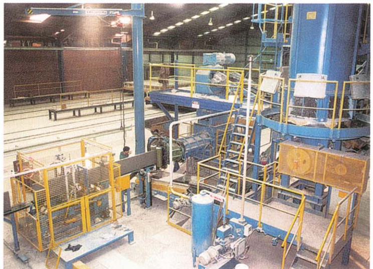
Formgebungsanlage mit Keller-HCW-Spaltplatten-Abschneider Shaping plant with Keller HCW split tile cutter
