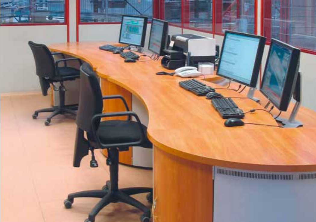
Schaltwarte Control room
