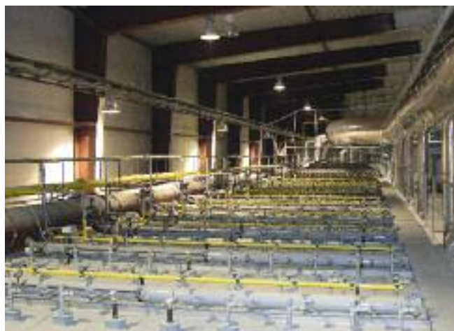
Deckenbrenneranlage Установка сводовых горелок
