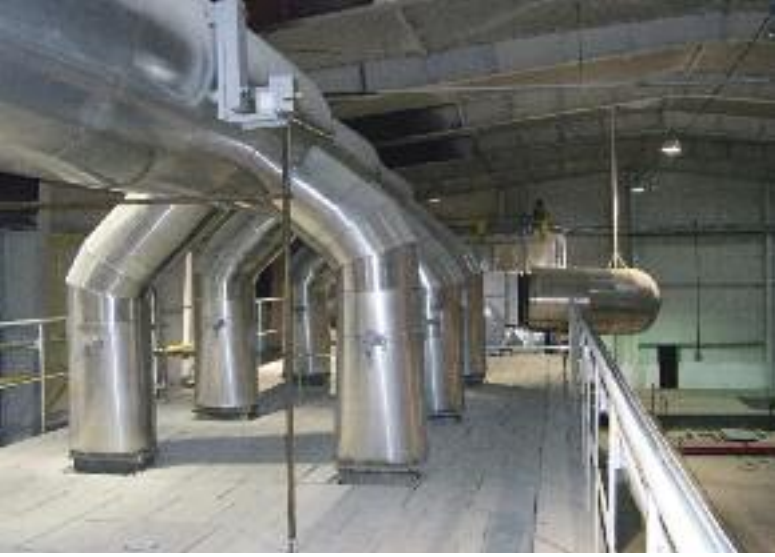
Untere Absaugung des Tunnelofens Вытяжная вентиляция, дутьевой вентилятор
