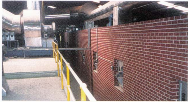
Die Umwälzventilatorantriebe des Tunneltrockners befinden sich auf idealer Wartungshöhe The recirculating fan drives of the tunnel dryer are at an ideal height for maintenance
