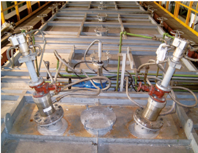
Bild 7 Trotz gleicher Messstelle zeigten die Geräte aufgrund einer falschen Fokuseinstellung große Temperaturunterschiede an
