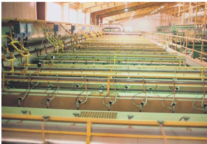
Gasbrenneranlage für die Befuerung des Tunnelofens auf der Ofendecke.
