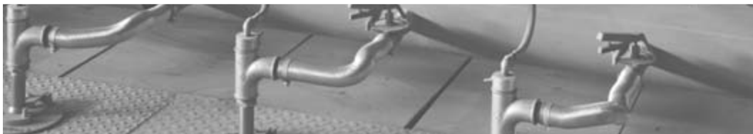
Deckenbrenneranlage auf Tunnelofen
