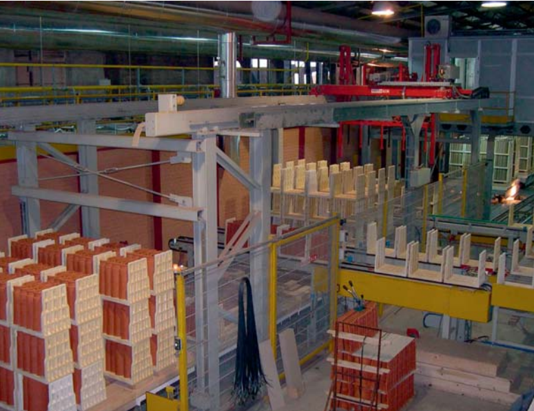
Ofenwagen Be- und Entladung Kiln car loading and unloading
