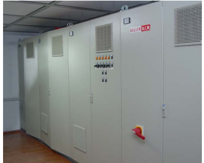
Die Schaltschränke sind in einer zentralen, klimatisierten Schaltwarte untergebracht The switchboards are arranged in a central airconditioned central room
