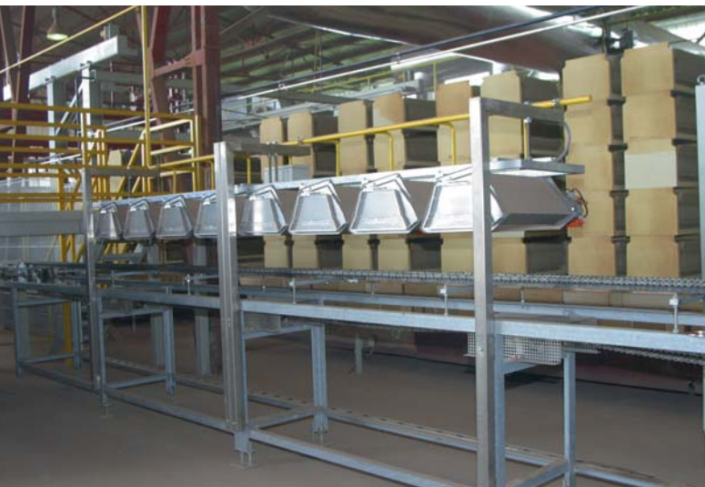
Trockenstrecke mit gasbetriebenen Heizstrahlern Drying section with gas-operated radiant heater
