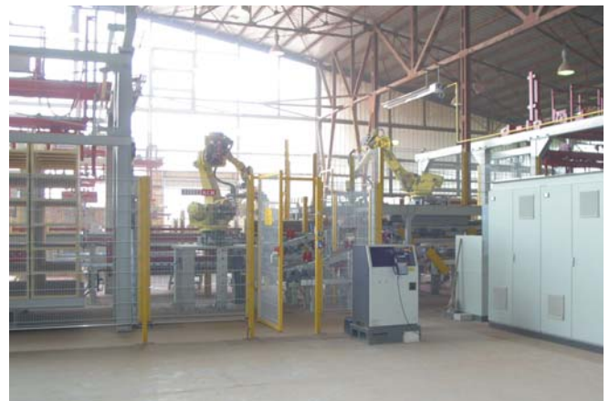
U-Kassettenanlage mit einem Roboter U-cassettes setting plant with robot
