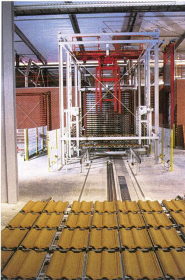
Das Übersetzen einer Gruppe Trockengutträger zur Trocknerwagen-Beladestation erledigt ein gleisgebundener Transportwagen A track-bound transport car transfers a group of pallets to the dryer car loading station
