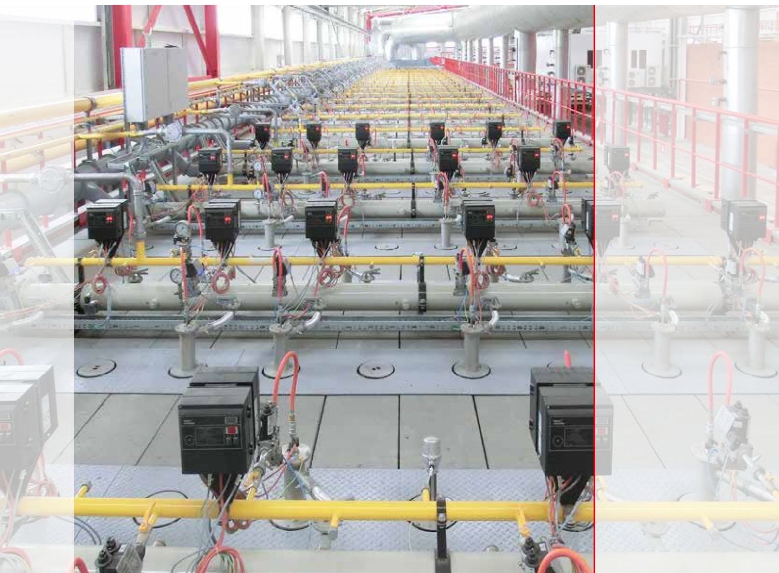
Top burner plant Système de brûleurs de voûte
