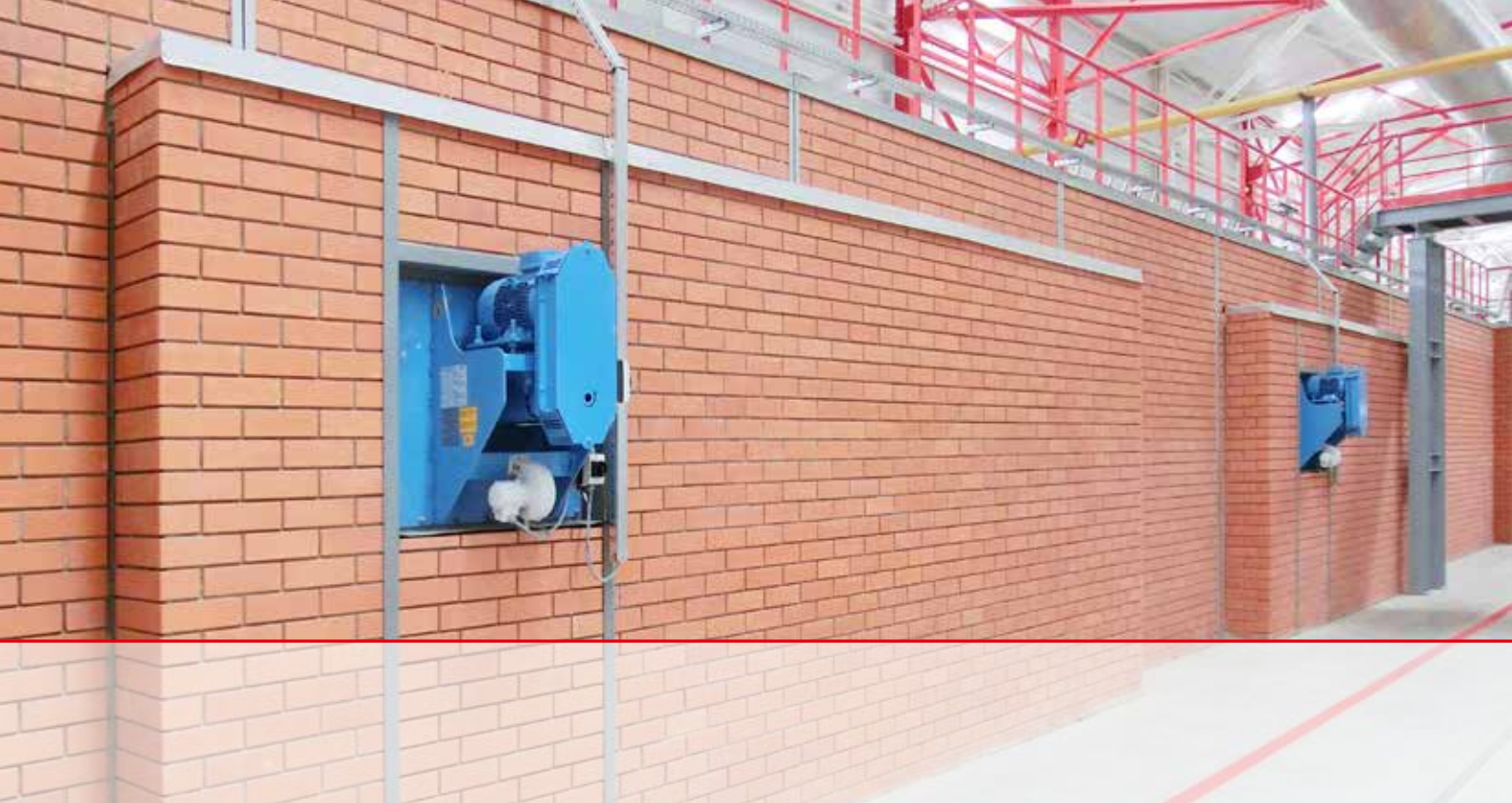
Flue gas circulation in the heating zone of the tunnel kiln Répartiteur de matière Synchron
